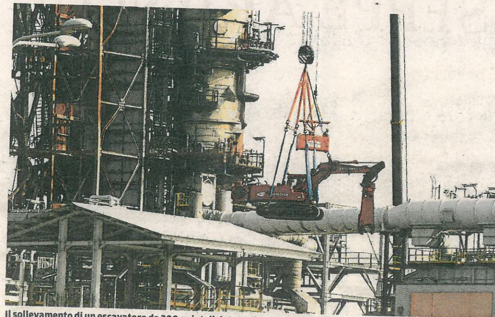
Il sollevamento di un escavatore da 300 quintali dotato di una pinza meccanica
