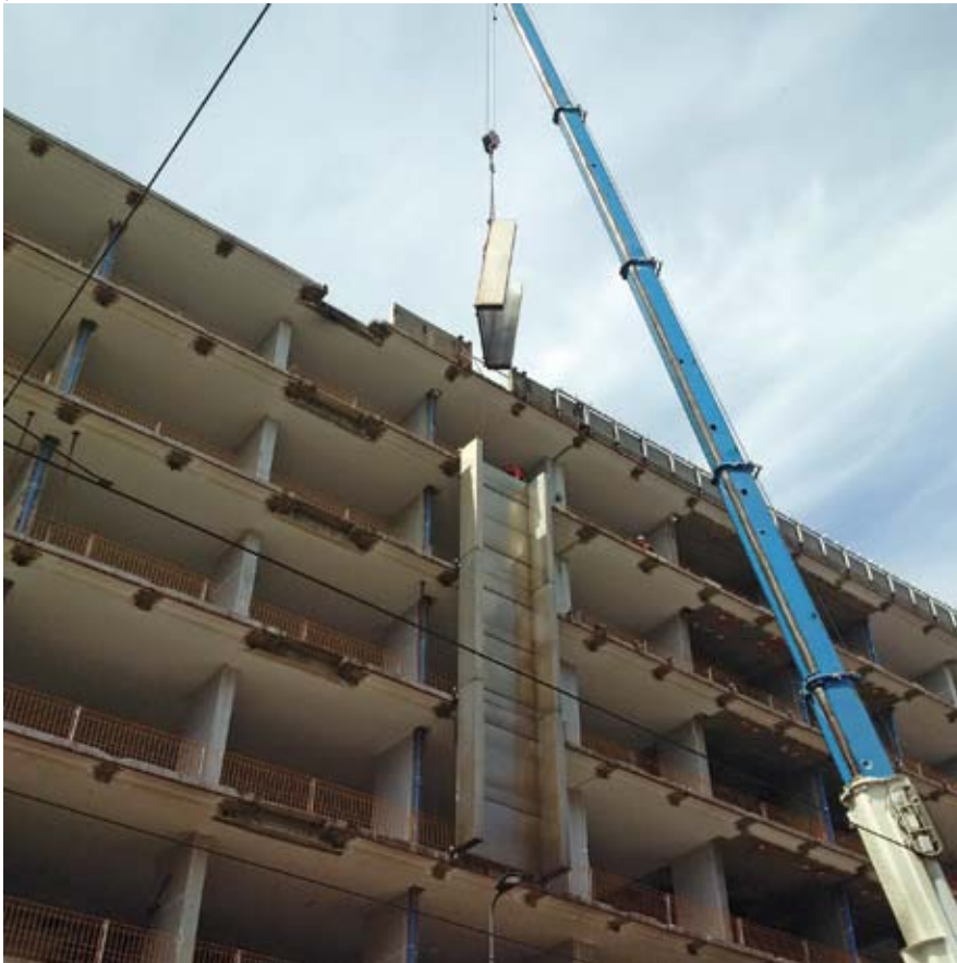
Intervento in facciata con autogru per l'abbassamento dei blocchi sezionati di metallo
